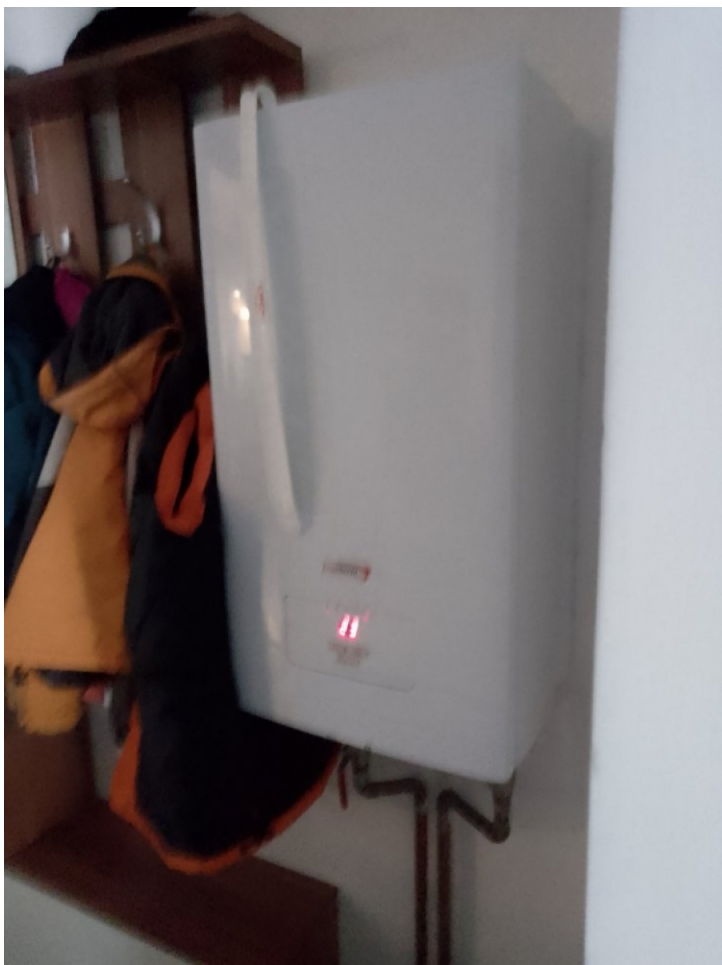
Elektrokotel Protherm - vytápění objektu SO 01
