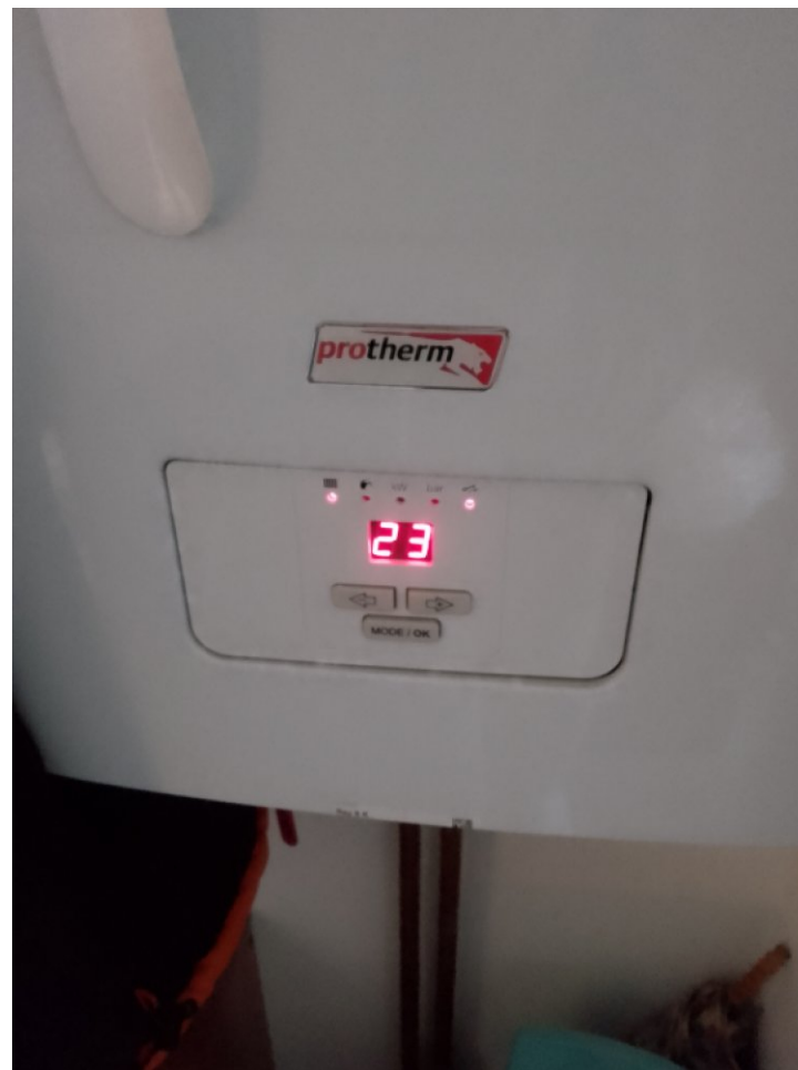
Elektrokotel Protherm - vytápění objektu SO 01-detail
