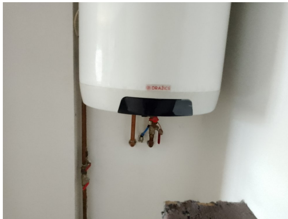
Zásobník TUV 146 l v chodbě 1.NP SO 01 - detail
