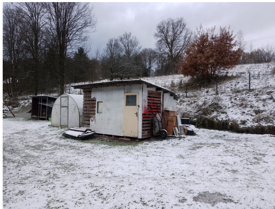
Objekt doporučený k odstranění.....
