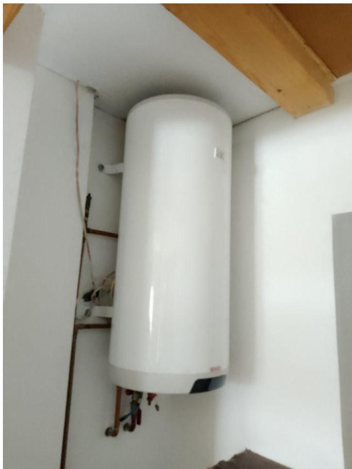
Zásobník TUV 146 l v chodbě 1.NP SO 01
