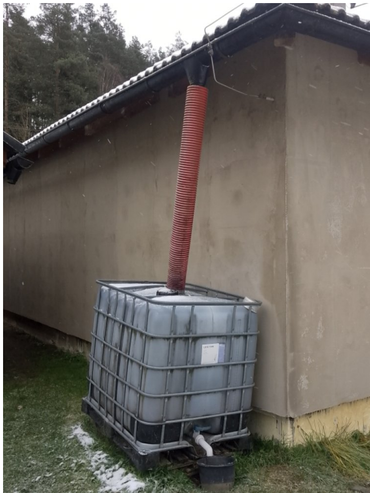
Nedokončená fasáda, svody, okapový chodník, gaigry objektu SO 01
