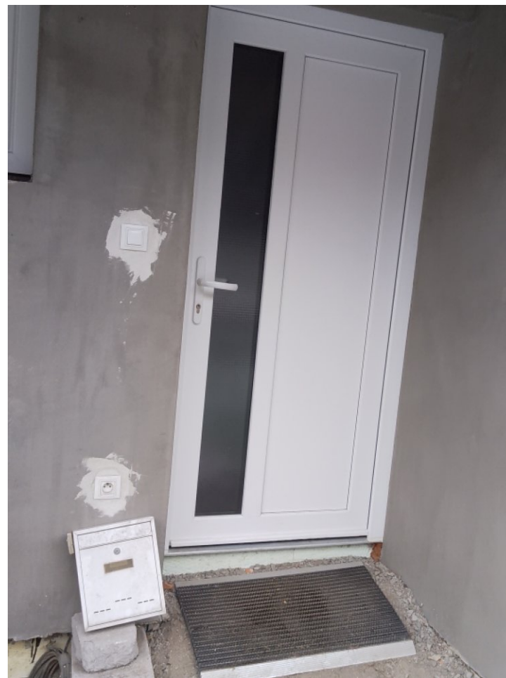
Plastové vstupní dveře objektu SO 01
