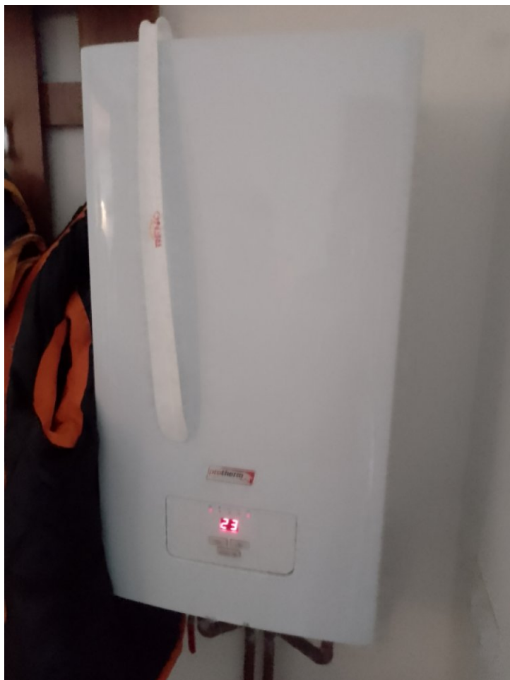
Elektrokotel Protherm ve vstupní chodbě
