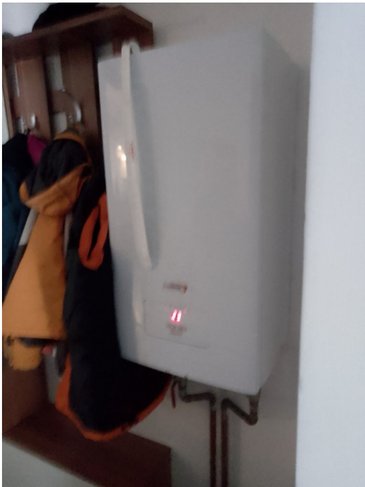
Elektrokotel Protherm - vytápění objektu SO 01
