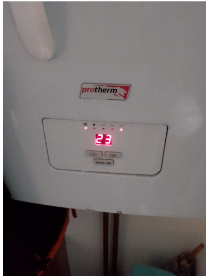
Elektrokotel Protherm - vytápění objektu SO 01-detail
